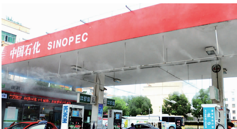
日前,记者在新安西街旁的加油站看到,加油站顶部装上了喷雾的加湿管道,每隔几分钟就会自动喷出水雾。据工作人员介绍,这个装置是去年下半年安装的,定时喷水雾能达到局部降温效果,减弱高温带来的安全隐患。 本报记者 王挺 摄
